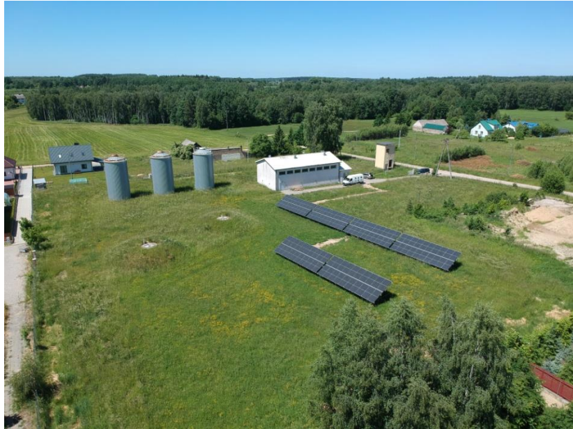
Instalacja fotowoltaiczna o mocy 44,04 kWp – stacja uzdatniania wody przy ul. Zdrojowej
