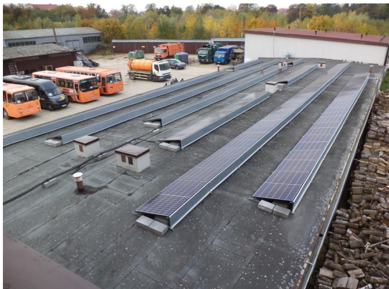
Instalacja fotowoltaiczna o mocy 29,60 kWp – baza transportowo – magazynowa ul. Kolejowa 21
